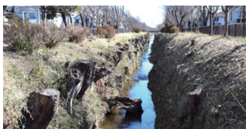
2025.2/11 根が崩落した 玉川上水
